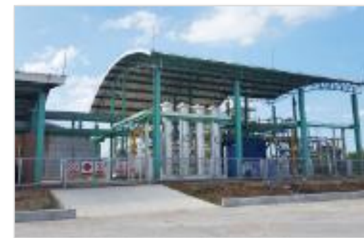
バイオガス精製システム（タイ）
